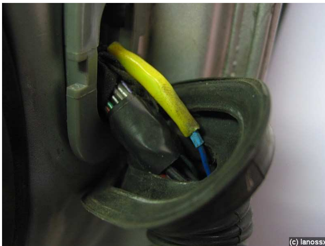
Na powyższym zdjęciu, dwie warstwy koszulek termokurczliwych, to BŁĄD. Połączenie jest za sztywne przewód przetarł się w miejscu lutu po trzech latach.
